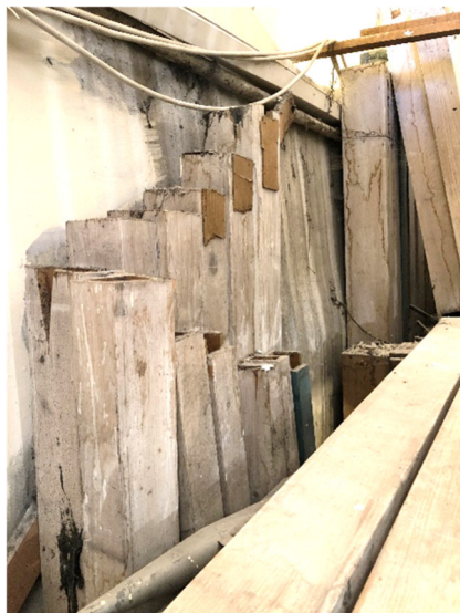
Canne in legno e infiltrazioni.
